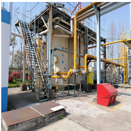
“碱吸收+活性炭吸附”装置
