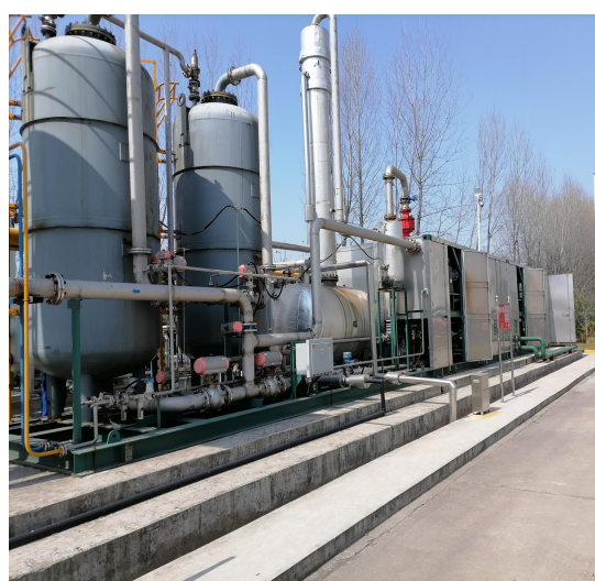
“吸收+深冷+活性炭吸附”装置
