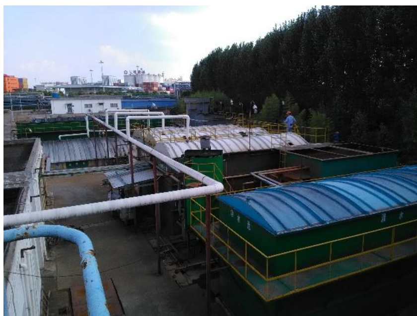
图4.1-2 废水综合处理装置
