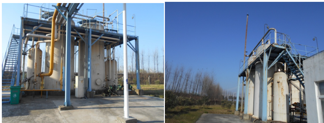
图 1-2(b)废气处理装置及其排气筒
