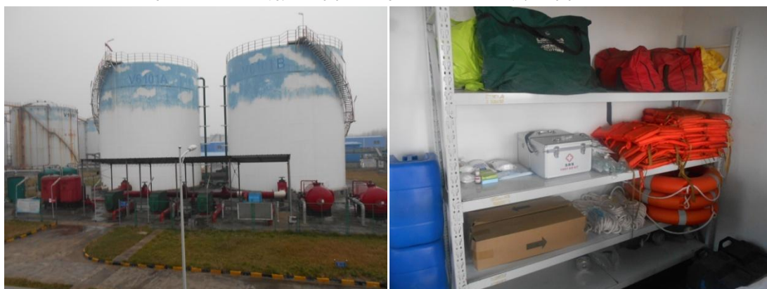
图 2.2-7 消防水罐及泡沫站图 2.2-8 应急物资
